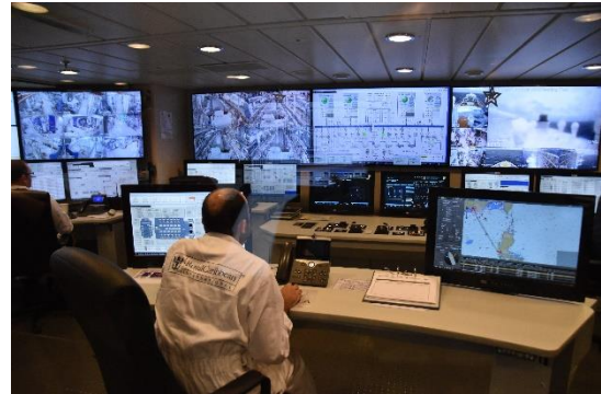
エンジンコントロールルームでは機関長から説明がありました。Safe Return to Port 規則を満足させるため、ディーゼル発電機は 2 機が別の区画に設置され、エンジンコントロールはブリッジでもできるようになっているので、推進機能の 2 重化ができているとのことでした。
