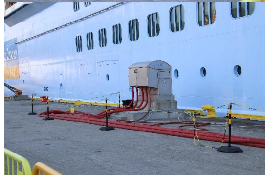
ノルウェーの港では陸上電源をとっていました。
