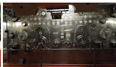
機関室の操作盤
